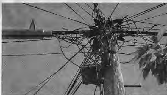
CAOTICO. Uno de los grandes problemas se detectaron en las columnas de la EPE, donde se mezcla el cableado.
